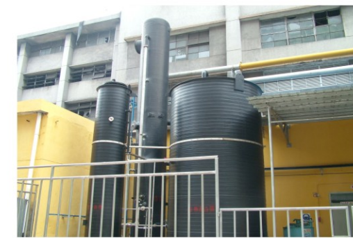
沼气发电前脱硫处理
